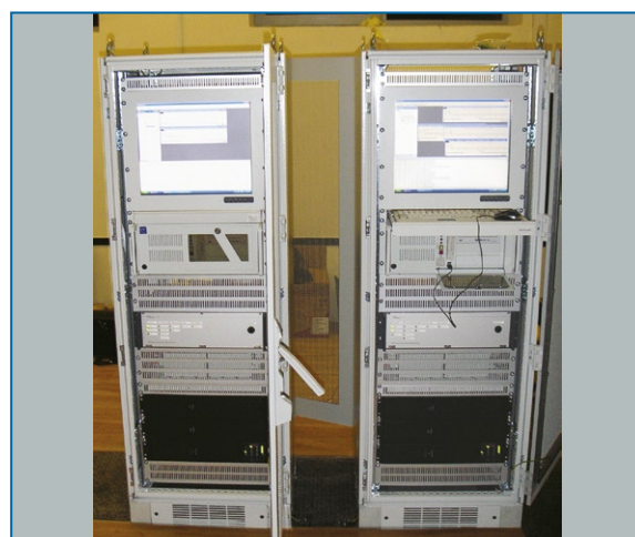
Фото 3 Шкафы с оборудованием системы мониторинга на ПС «ММДЦ»
